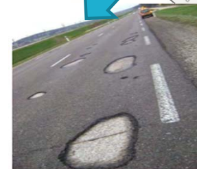
Observations identiques sur BB recouvrant anciennes dalles béton
